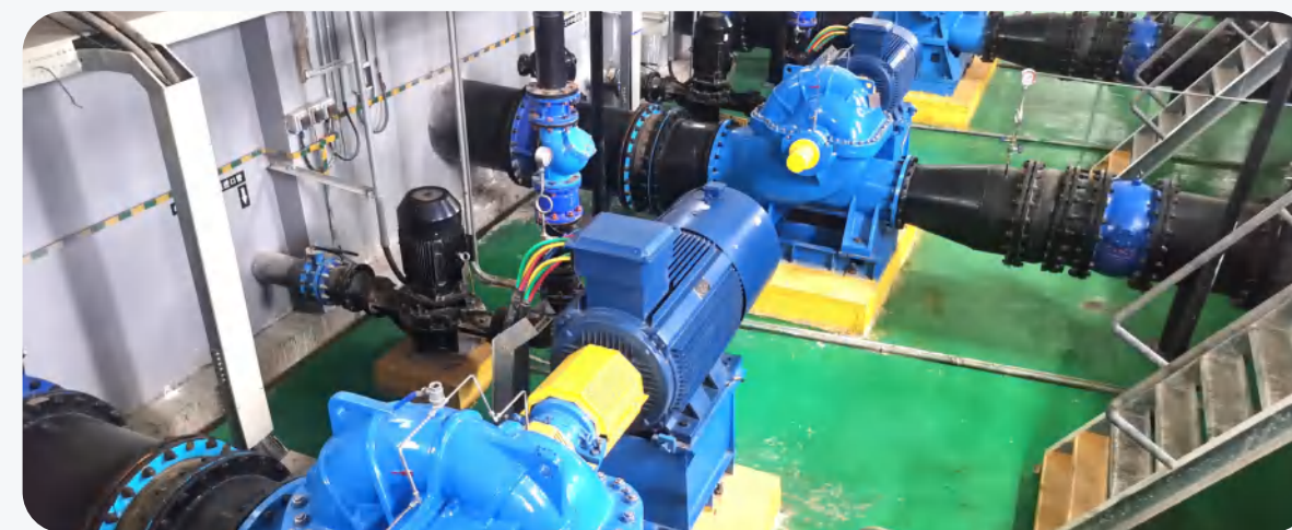
改造后循环水泵
