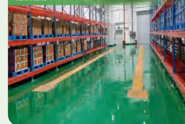
“负压收集+除臭系统”、消防喷淋系统、有毒有害气体监测系统 系统及可视化监控系统
